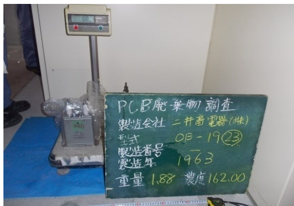
写真 9 PCB 機器の記録写真
