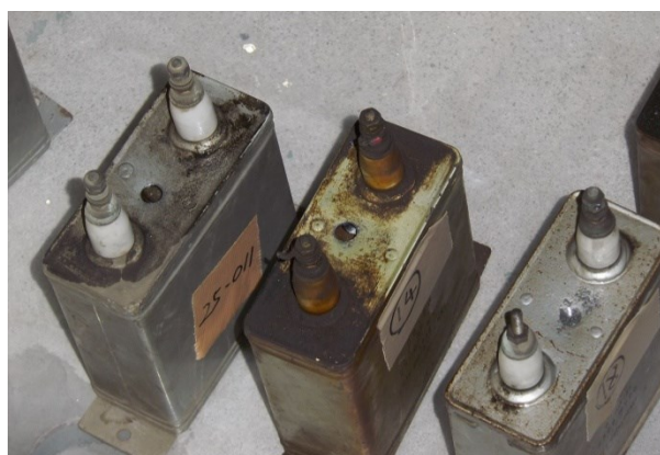
写真 8 二井蓄電器㈱製のコンデンサ
