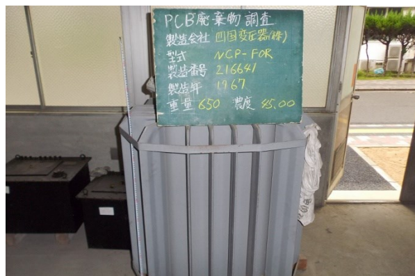
写真 11 低濃度トランスの保管状況
